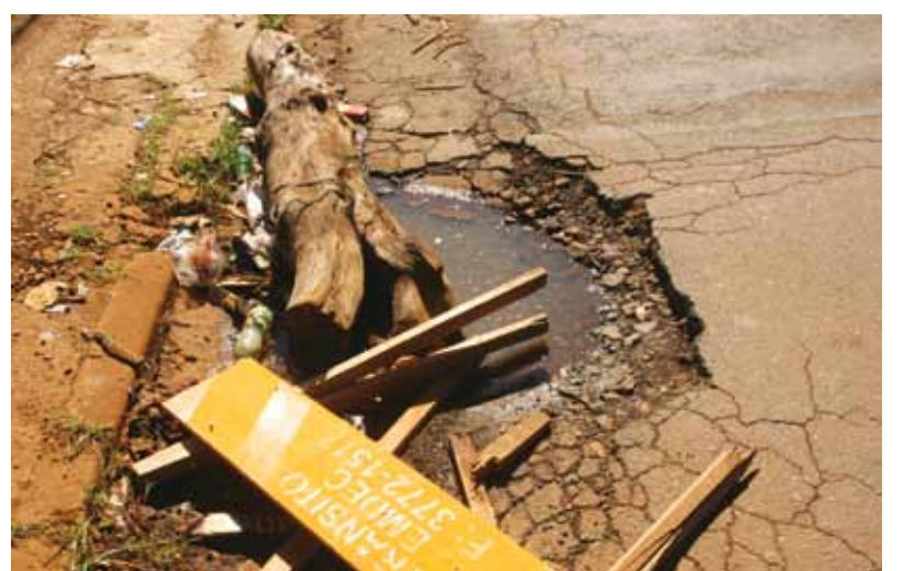
Buraco localizado na Rua das Hortências: tem sempre um tronco de árvore dentro dele
